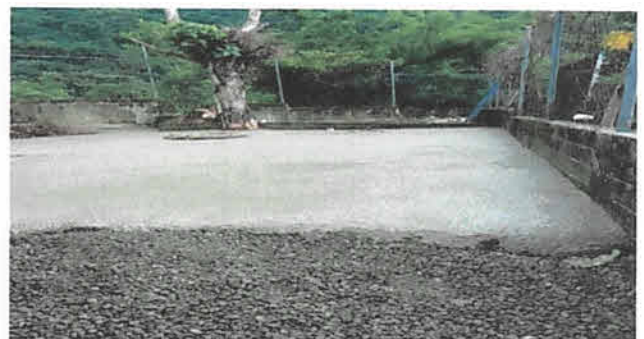
Foto 16: Torta de Cemento frente lavamanos
